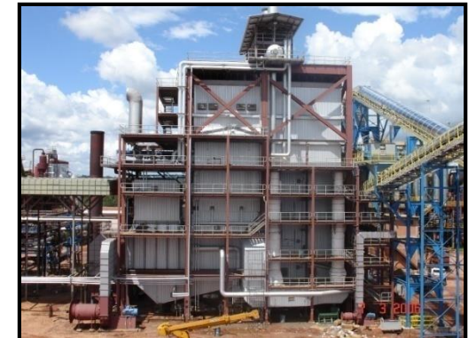
Caldeira 300 TVH – 67 bar – 520°C Grupo Sta. Terezinha
